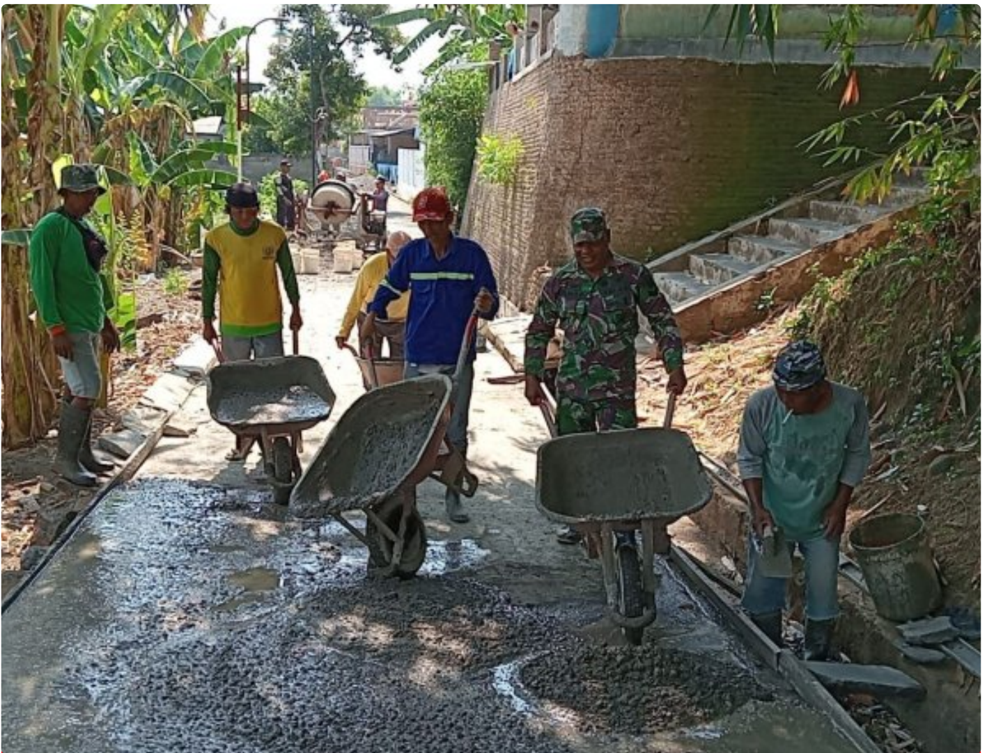
Tingkatan Infrastruktur, Babinsa Bersama Warga Karya Bakti Cor Jalan Desa Wadunggetas Klaten
